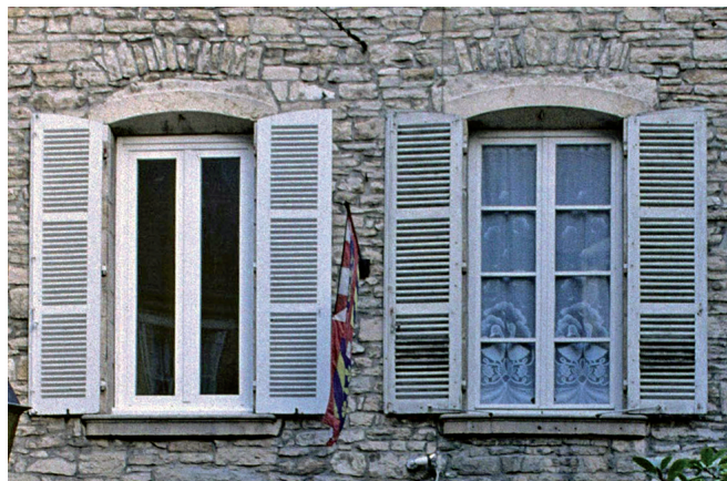
Nouvelle fenêtre (à gauche) dont l'esthétique est loin de celle de la fenêtre d'origine (à droite) en raison de l'absence de petits bois, un châssis trop large, un matériau et une couleur mal choisis. Photo : Bulletin NIKE n° 5/04.
